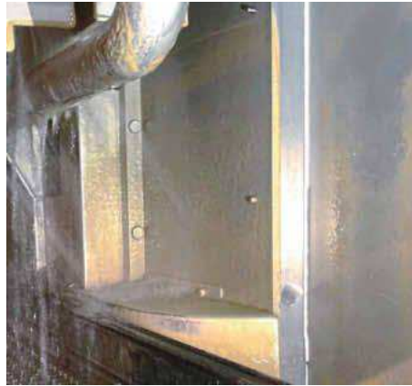
Tunnelpasteur mit Biofilm-Ablagerungen im Auslauf
