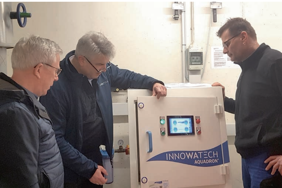
Regelmäßige Wartungen durch das Innowatech-Serviceteam sorgen für den zuverlässigen Betrieb der Aquadron-Anlage: Dipl.-Ing. Dieter Grimm (li.) und Frank Broghammer (re.) mit Innowatech-Vertriebschef Michael Knauf.
