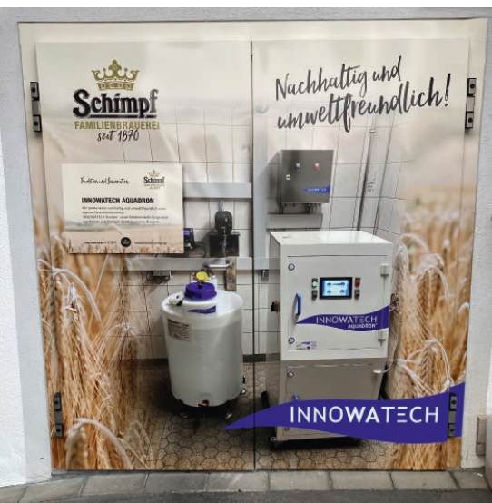
Nachhaltig und umweltfreundlich – so geht schonende Wasserdesinfektion heute. Mit diesem Motiv hat Geschäftsführer Schimpf die Zugangstür zur Desinfektionsanlage gestaltet. (Bilder: Kronenbrauerei Alfred Schimpf)
