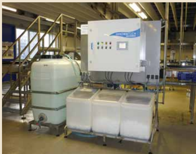
Abb. 1 Aquadron-Anlage im Betrieb
