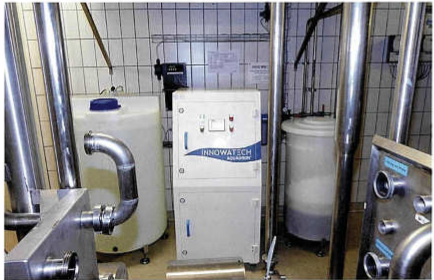
Rechts der Behälter mit Kochsalz-Tabletten, links der mit fertigem „Innowatech Anolyte“, dazwischen der Elektrolyse-Reaktor
