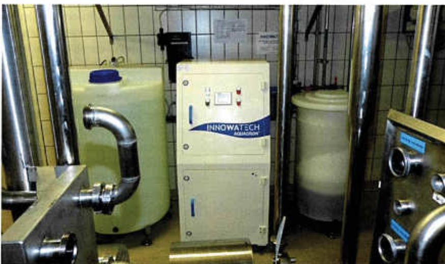
Rechts der Behälter mit Kochsalz-Tabletten, links der mit fertigem „Innowatech Anolyte“, dazwischen der Elektrolyse-Reaktor. Günstiger und effektiver kann man Wasser nicht keimfrei machen.
