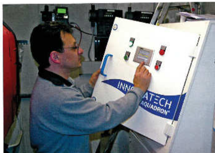
Einfache Kontrolle und Bedienung der Aquadron Anlage über Touchscreen
