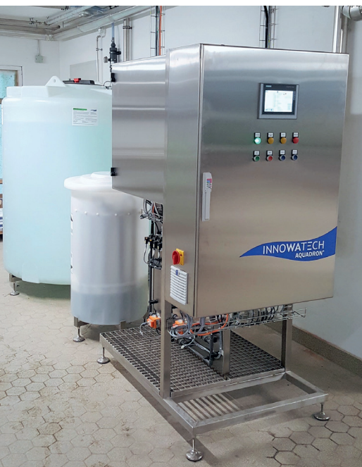
INNOWATECH Aquadron SG2 zur Herstellung von INNOWATECH Anolyte® in der Molkerei
