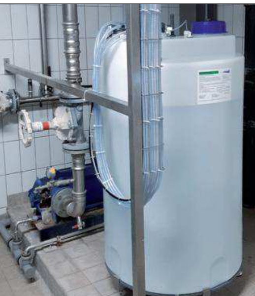
Trotz der vielen Desinfektionsanwendungen ist der Anolyte-Vorratstank so klein wie möglich ausgelegt. Die Just-in-time-Produktion und kurze Wirkstoff-Lagerzeiten garantieren eine hohe Wirkstoffreinheit. So wird die Produktion von Desinfektionsnebenprodukten (THM, Chlorat) auf ein Minimum reduziert. (Bild: Innowatech)
