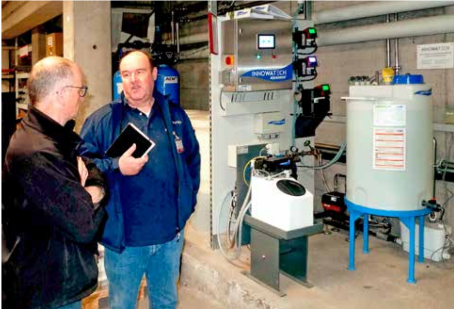
Frank Illhardt (li.), Leiter der Gebäudetechnik bei der Unternehmensgruppe Fischer, und Volker Fischer, Geschäftsführer der Innowatech GmbH, beim Vor-Ort-Termin.
