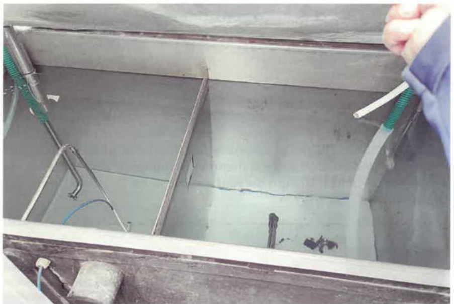
Kühlwasser behandelt mit herkömmlichem Biozid (oben) und danach mit »Anolyte« innerhalb der Trinkwasserverordnung (unten).
