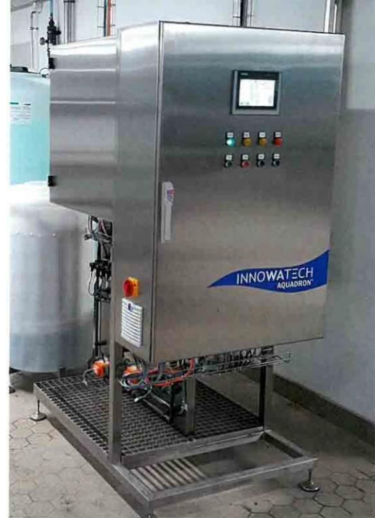
Planta Aquadron SG2 en funcionamiento en la lechería Berchtesgadener Land Chiemgau eG.
