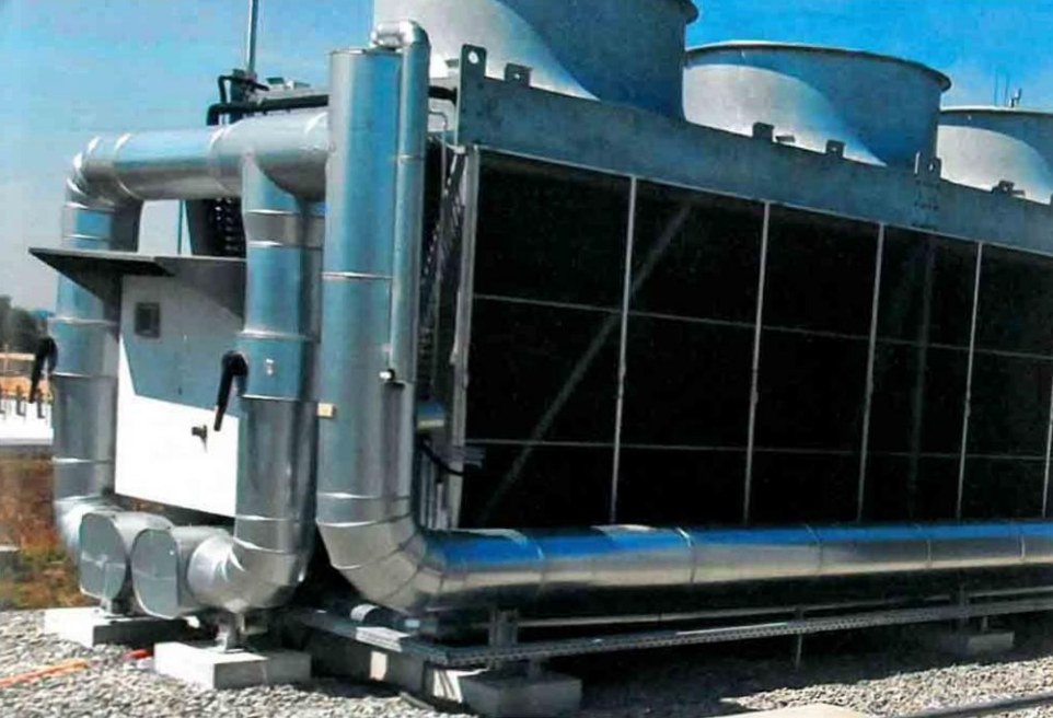
El tratamiento de agua de refrigeración en torres de enfriamiento está destinado para evitar la contaminación con Legionellas.
