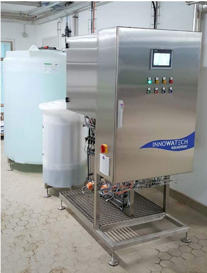
Abb. 2: Aquadron SG 2 bei den Milchwerken Berchtesgadener Land Chiemgau.
