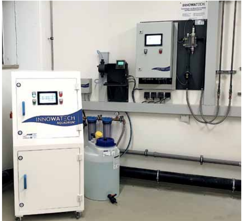
④ Innowatech Aquadron mit Multi-Mess-Center zur Trinkwasserbehandlung
