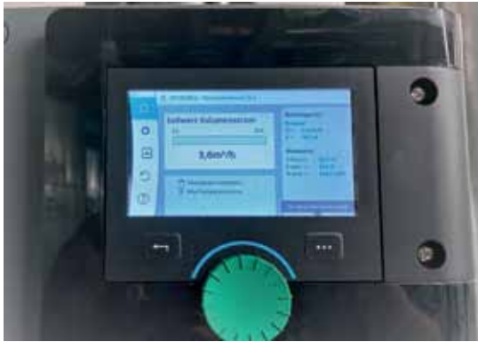
② Zirkulationspumpe mit Anzeige der Leistungsdaten und Wassertemperatur
