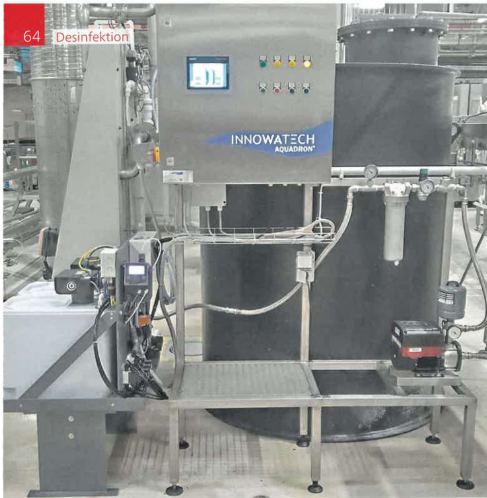
Einsatzbeispiel in der AfG-Produktion: Die Anlage produziert das Desinfektionsmittel für die permanente Desinfektion während der Abfüllung. Dadurch reduziert sich der Einsatz von Kaltsterilisationsmitteln. Bilder: Innowatech
